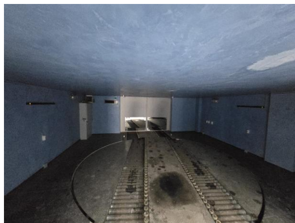
Pazemese stāvvietas telpa, no kuras automatizēti mašīnas tiek transportētas uz lietošanā esošo auto novietnes šūnu
